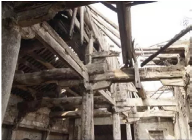
屋面破损之后的木屋架
